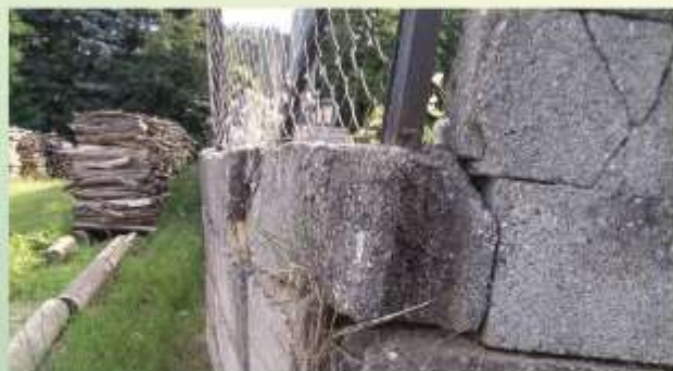
Rascher Handlungsbedarf bei einsturzgefährdeter Friedhofsmauer in Pföding.
